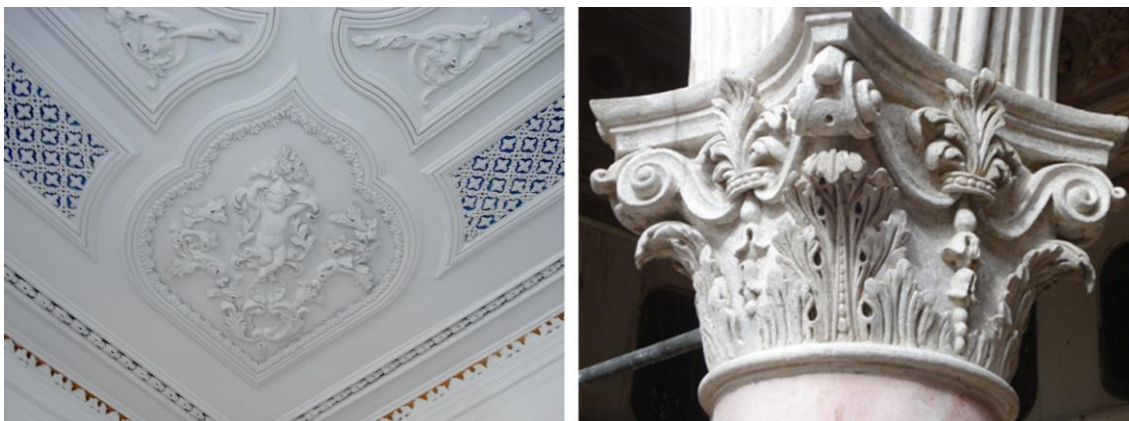
Figura 1: Na imagem à esquerda: Relevos em estuque do sobrado residencial do barão de Butuí. Fonte: Foto dos autores, 2010. Na imagem à direita: Capitel estucado com acantos e volutas da residência do barão de São Luis. Fonte: Foto dos autores, 2009.
